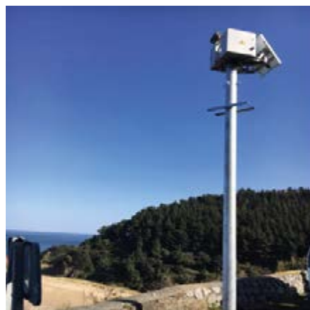
12. Fig. Instalación de la estación de videometría litoral de la playa de Saturrarán
